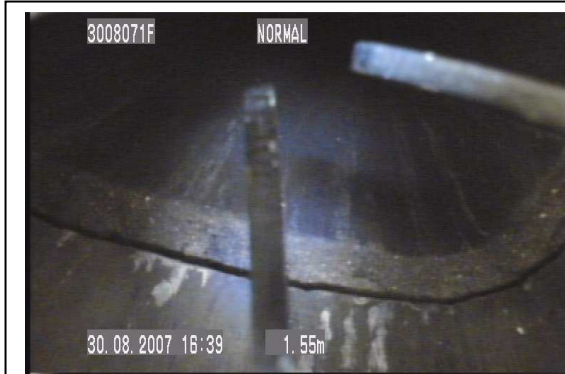
Nr. 1 Beschädigung Innenrohr: 1,55 m von dem oberen Reinigungsverschluss nach unten aus gesehen
