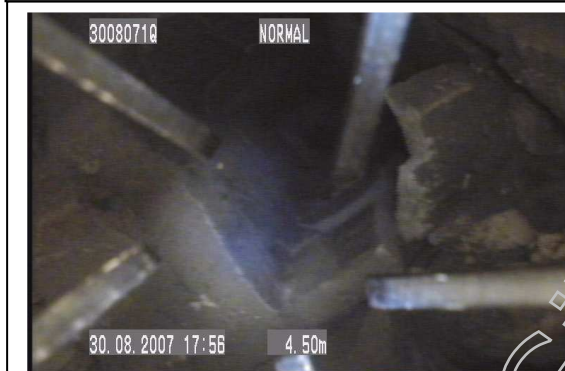
Nr. 3 Beschädigung des Innenrohres beim Abgasrohranschluss 4,50 m von dem oberen Reinigungsverschluss nach unten aus gesehen
